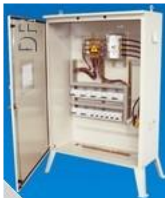
Armoire de répartition générale
